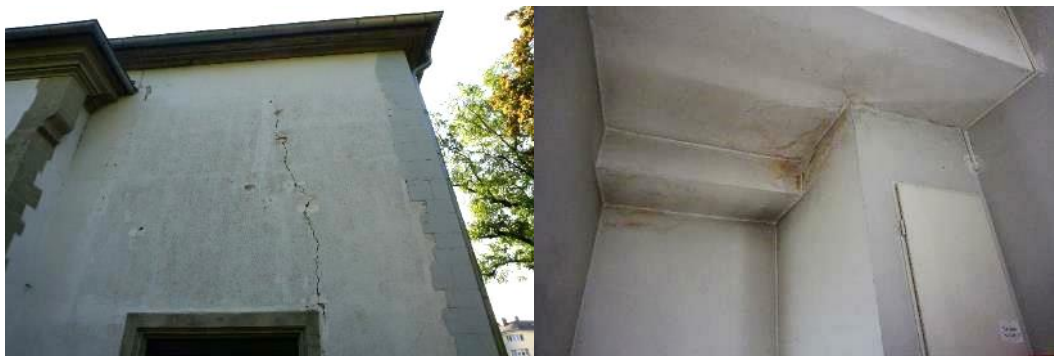
Riss in der Gebäudehülle und Wasserschaden im Treppenhaus
